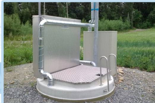
Desinfinator AeroPro 3000 installerad vid en Grundfos avloppsvatten- pumpstation.
